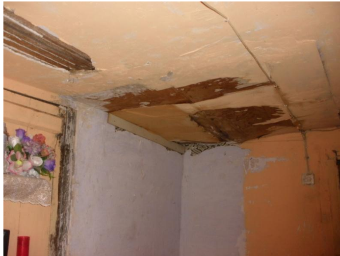
vivienda en planta 2ª (humedades, desconchamientos)
