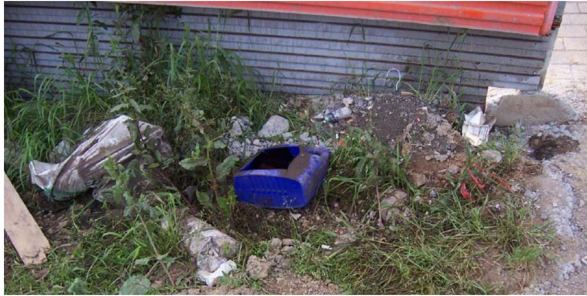
Ejemplo de residuos de obra que no deberán permanecer tras la ejecución de ésta
