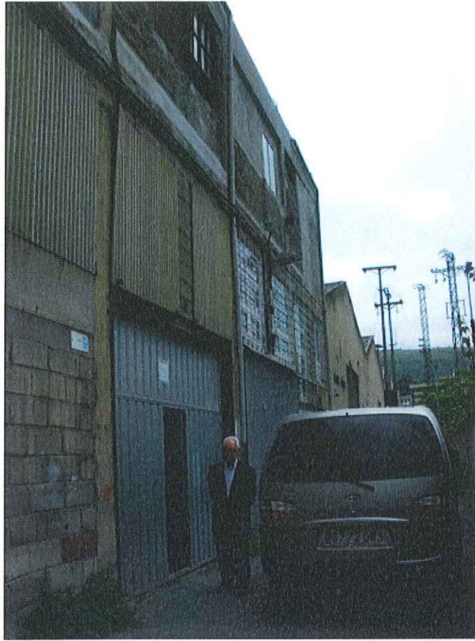
EXTERIOR PORTAL EN PLANTA BAJA DE ACCESO A LOCAL INDUSTRIAL EN P. 1ª
