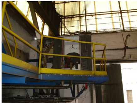
Equipo refrigeración Géminis N °4
