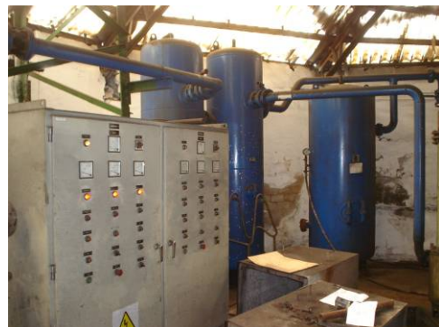
Depósitos acumuladores compresor
