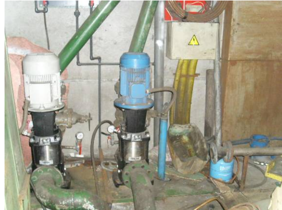
2 Bombas agua refrigeración M9
