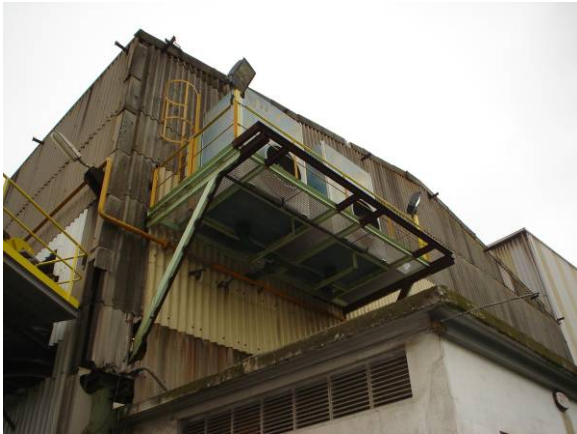
Torre refrigeración Máq. Nº 8/molinetes horno HT-Q1
