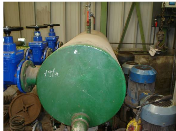
4 Bombas retorno a fosos
