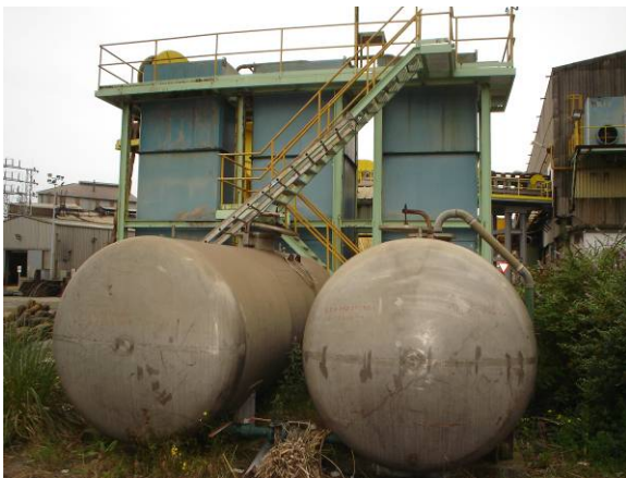
Torres agua de refrigeración fosos HT-1
