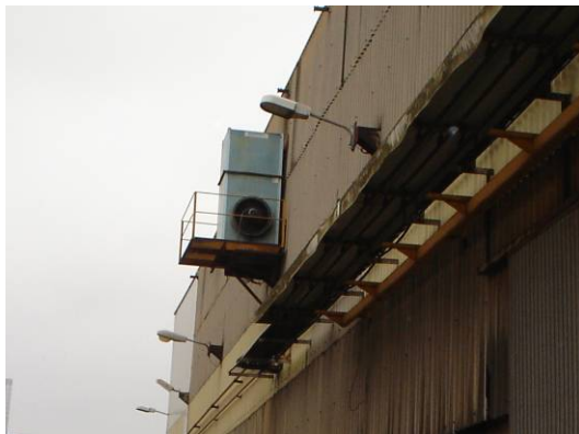
Torre agua de refrigeración Máquina N° 1
