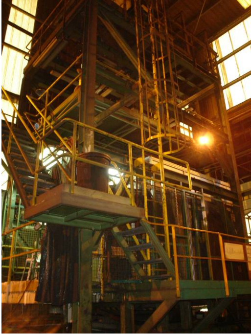
Torre de Inspección posterior al Horno HT-1
