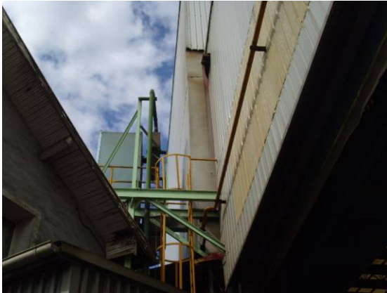
Torre agua de refrigeración M9
