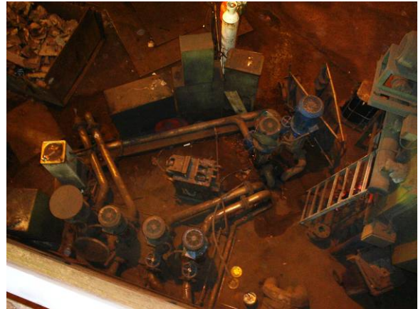
Bombas agua refrigeración Máquina Nº 8
