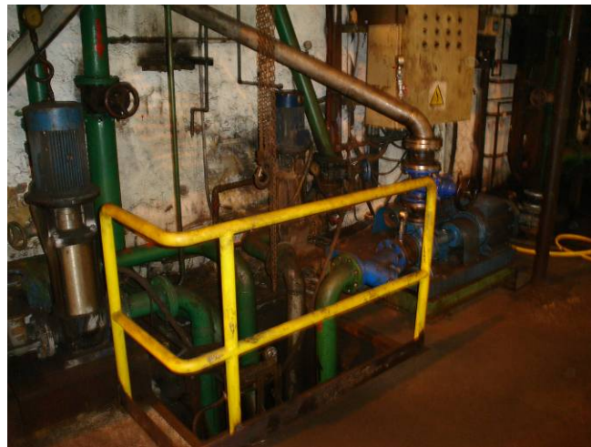
Bombas impulsión agua de refrigeración maquinas 5-3-2 y molinetes HT-2 a torre
